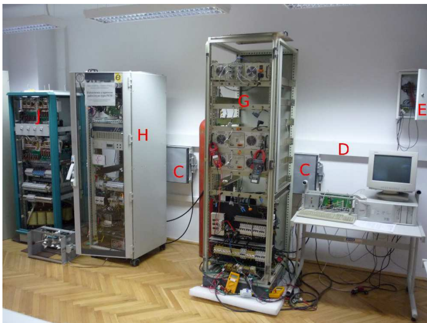
Rys. 1. Widok mikrosieci prądu stałego w ZEiGE, IEn, PW
